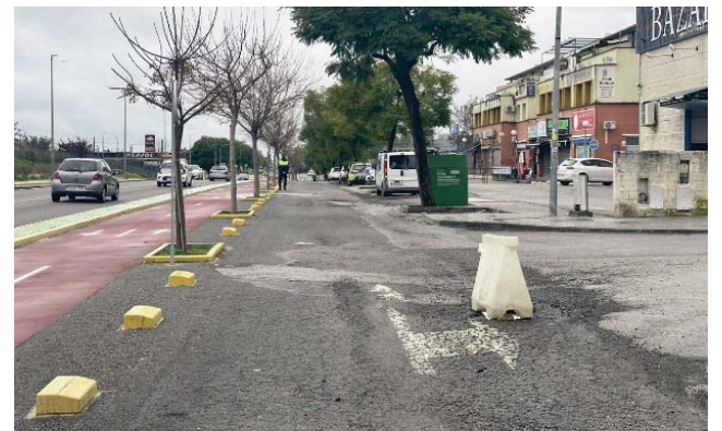
Imagen de la A-474 antes del reasfaltado. AYTO BORMUJOS
