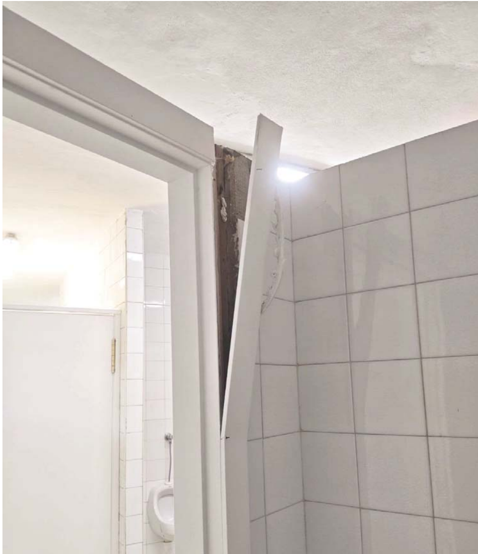
Imagen de los daños. AYTO BORMUJOS
